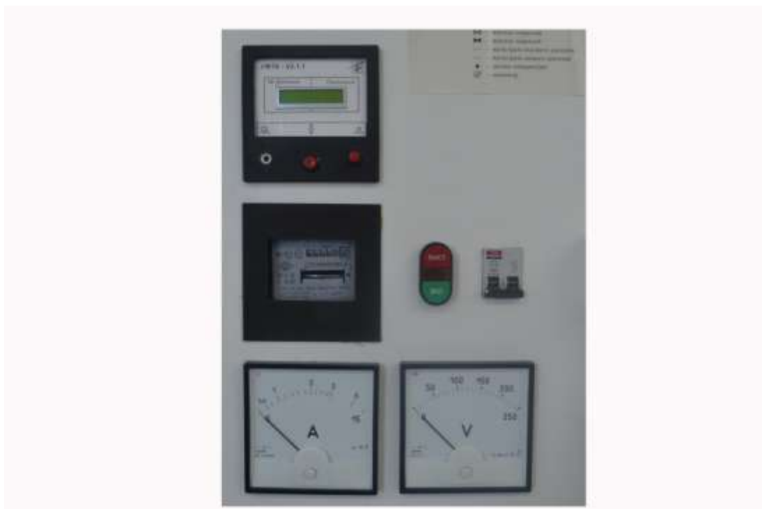
Рис.8.2 – Блок управления и защиты стенда
